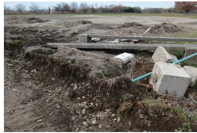
被害を受けた荒川緑地ソフトボール場
