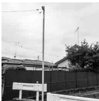
LED化された防犯灯
