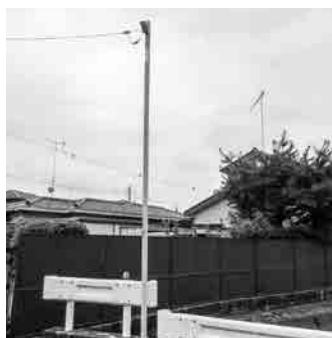
LED化された防犯灯
