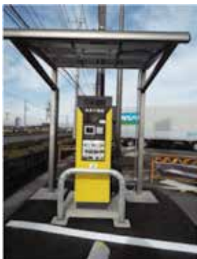
急速充電設備
