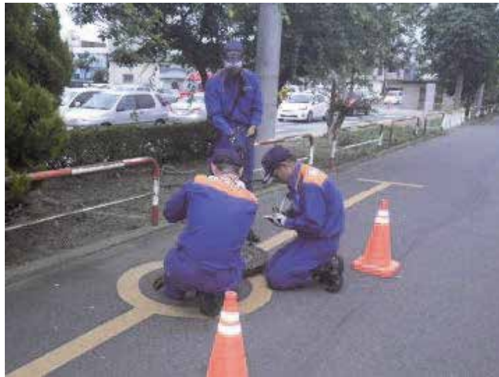
消防水利点検
