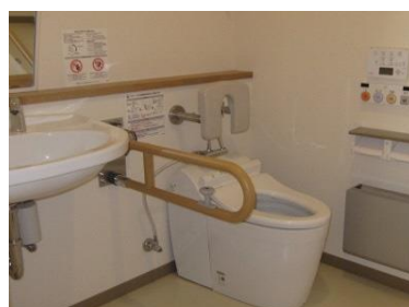
トイレ(温水洗浄便座・センサー照明)
