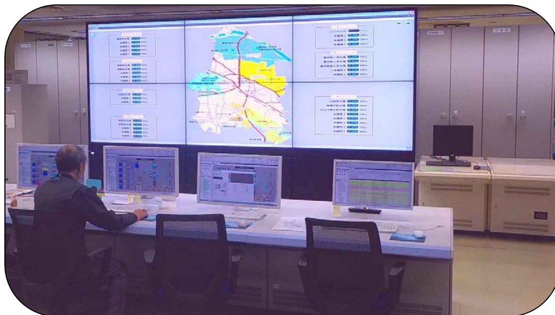
図 3-3.中央監視設備（東部浄水場）
