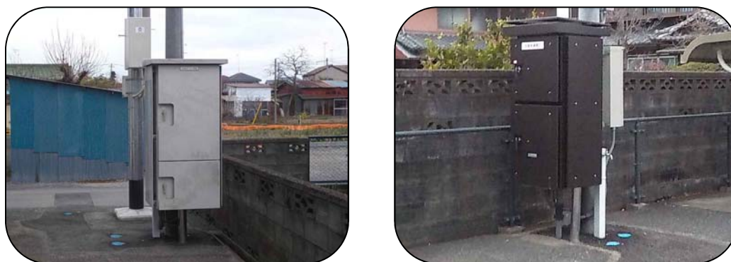
図 3-5.末端監視装置
