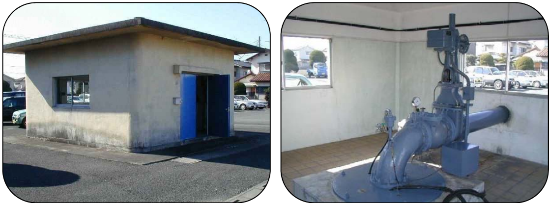
図 3-2.水源施設（東部1号取水井）
