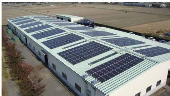
めぬま有機センター太陽光発電システム
