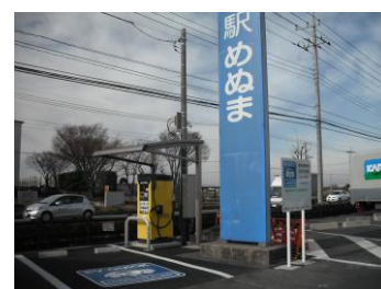
道の駅めぬま 電気自動車充電設備
