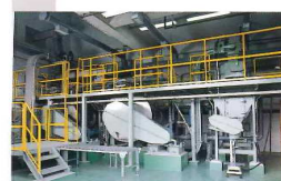
コンポスト設備 給食センターの生ゴミと乾燥汚泥を混合して微生物の力により発酵させ、コンポストを製造します。
