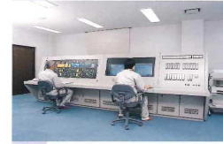
中央監視室 中央監視室では施設全体の運転状況が、コンピュータにより監視され効率のよい運転管理を行っています。
