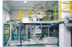
前処理設備 し尿、浄化槽汚泥に含まれる、紙、布、ビニールなどの夾雑物を取り除きます。
