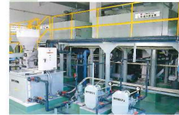
汚泥脱水機 主処理と高度処理で発生する汚泥は一緒に脱水機により脱水されます。
