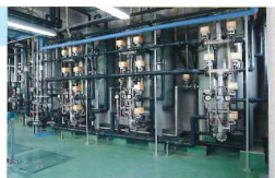
砂ろ過・活性炭吸着塔設備
