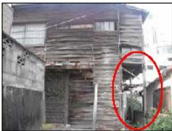
柱の数ヶ所に破損がある例（50点）
