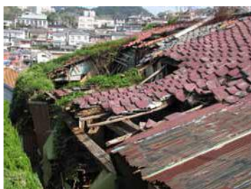
①屋根ぶき材料に著しい剥落がある例
