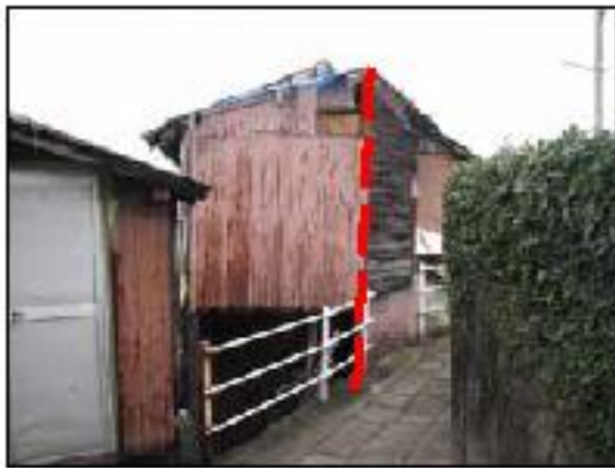
一部の柱が傾斜している例（25点）
