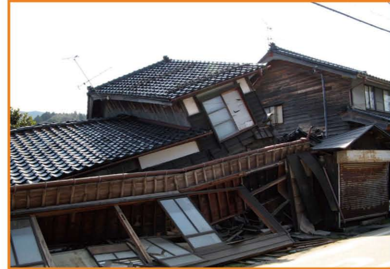
地震による建物被害の例
