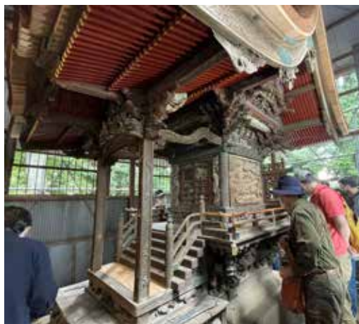
〔県指定有形文化財・建造物「諏訪神社本殿」 保存修理後特別公開〕
