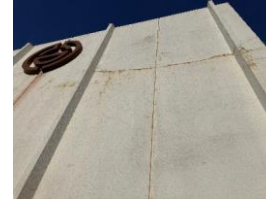
屋上(外壁のひび割れ)
