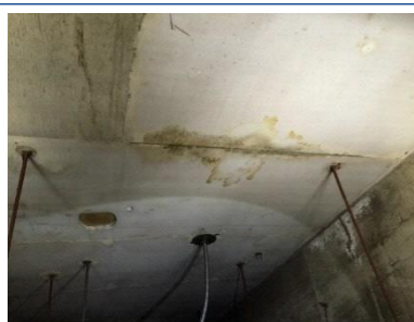
天井裏(雨漏り)
