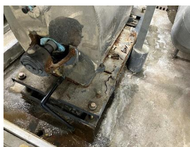
機械設備(配管劣化)
