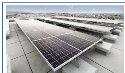
太陽光発電設備
