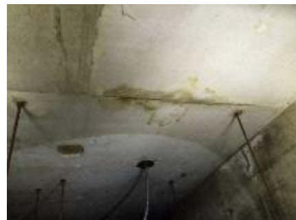
天井裏（雨漏り）
