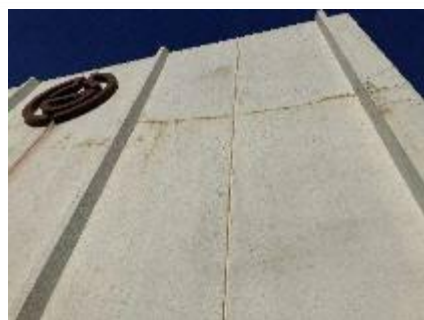
外壁のひび割れ
