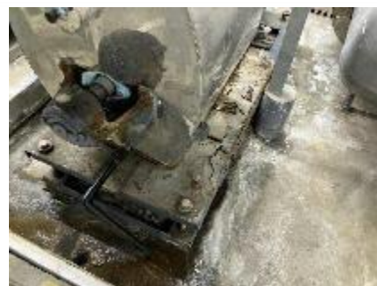
機械設備（配管劣化）
