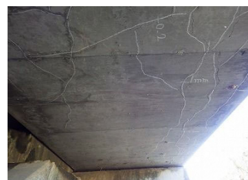
ひびわれ コンクリートにひびわれが入っている状態
