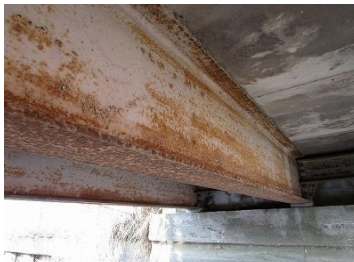
腐食 鋼材が錆びている状態
