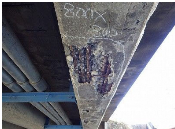
鉄筋露出 コンクリートが割れ、鉄筋が見えている状態
