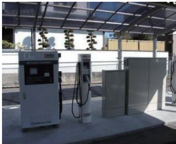
江南行政センターに設置されている急速充電器
