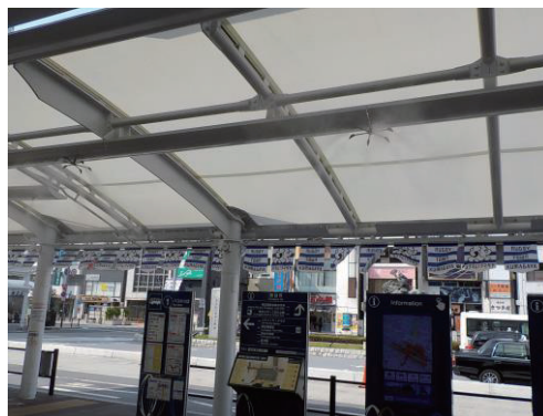
熊谷駅正面口冷却ミスト装置
