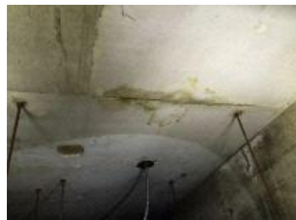
天井裏（雨漏り）
