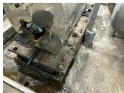
機械設備（配管劣化）
