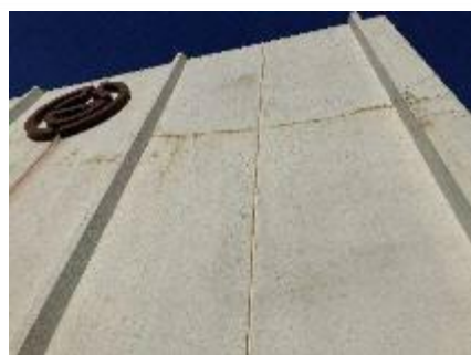
外壁のひび割れ
