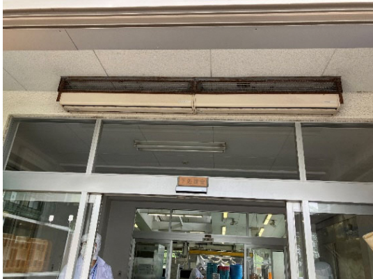
食材搬入口（設備の故障あり）
