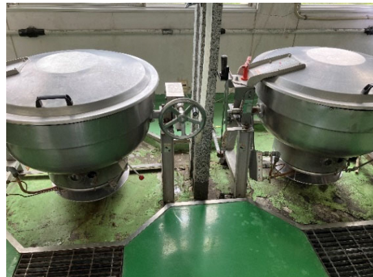
調理室（一部で雨漏りあり）
