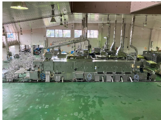
コンテナ室（床の修繕が必要）
