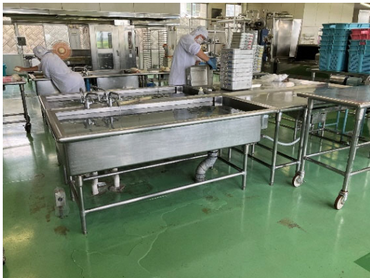
調理室（設備の老朽化、水漏れあり）
