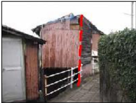
一部の柱が傾斜している例（25点）
