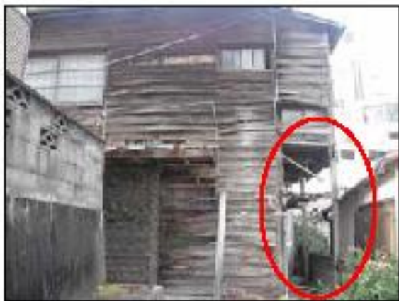
柱の数ヶ所に破損がある例（50点）
