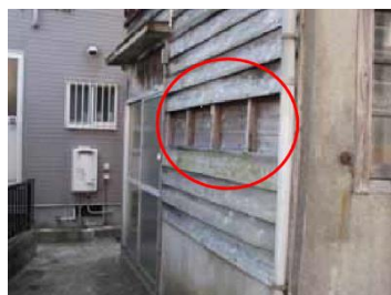
②外壁の仕上材の一部がはがれ、下地が露出している例
