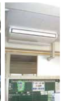
中学校に整備されたエアコン
