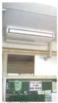
中学校に整備されたエアコン
